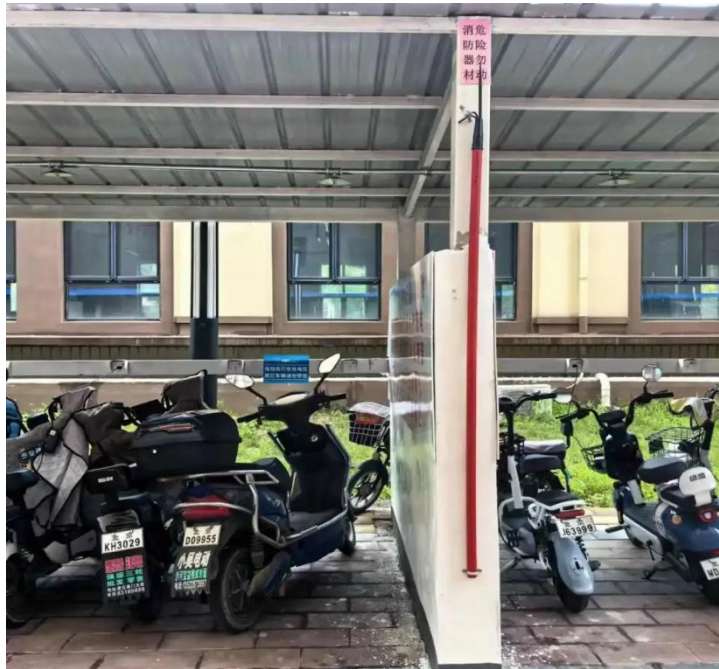
图 5. 充电区域的 1.5 米防火隔墙
